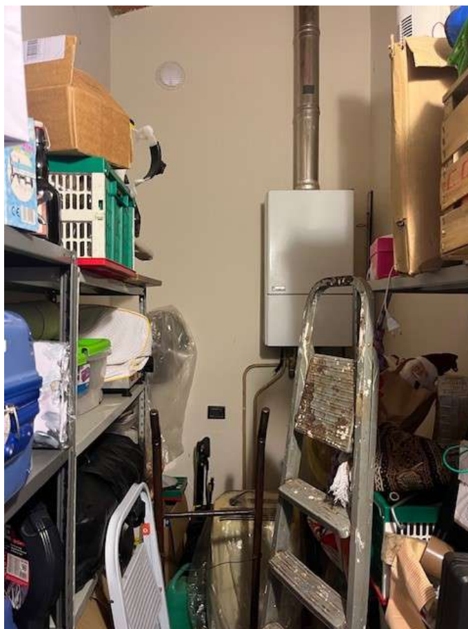
Fotografia 31 – Caldaia nel ripostiglio locale accessori
